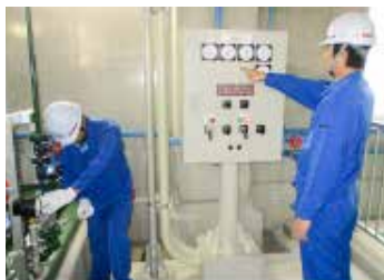
上下水道施設維持管理
