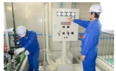
上下水道施設維持管理
