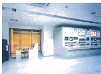
ゴミ・し尿処理施設維持管理
