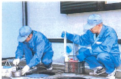
浄化槽の保守点検 維持管理
